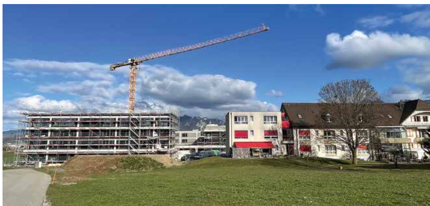
L'EMS de la Sionge à dix mois de sa mise en service (photo J.-B. Repond)
