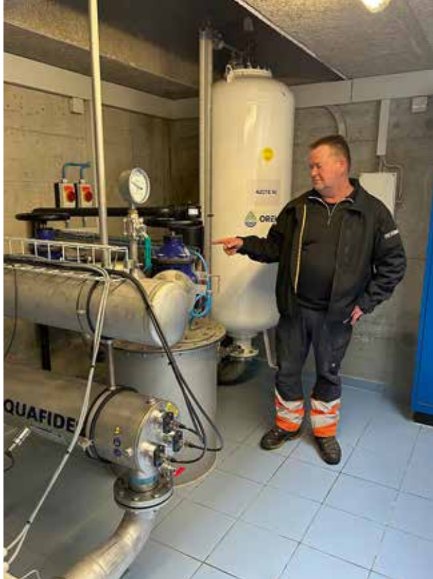
Au puits de la Moille, le système de désinfection UV se trouve au premier plan. Pierre-Alain Moret désigne la tête de puits qui va puiser l'eau à 24 mètres de profondeur. Le cylindre blanc est un ballon d'équilibrage pour éviter les à-coups de pression ou coups de bélier (photo P.-A. Genoud)
